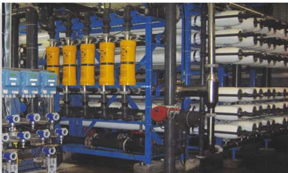
"Sistema de Ósmosis Inversa equipado con un Dispositivo de Reducción de Energía Isobárico (cilindros amarillos)"
